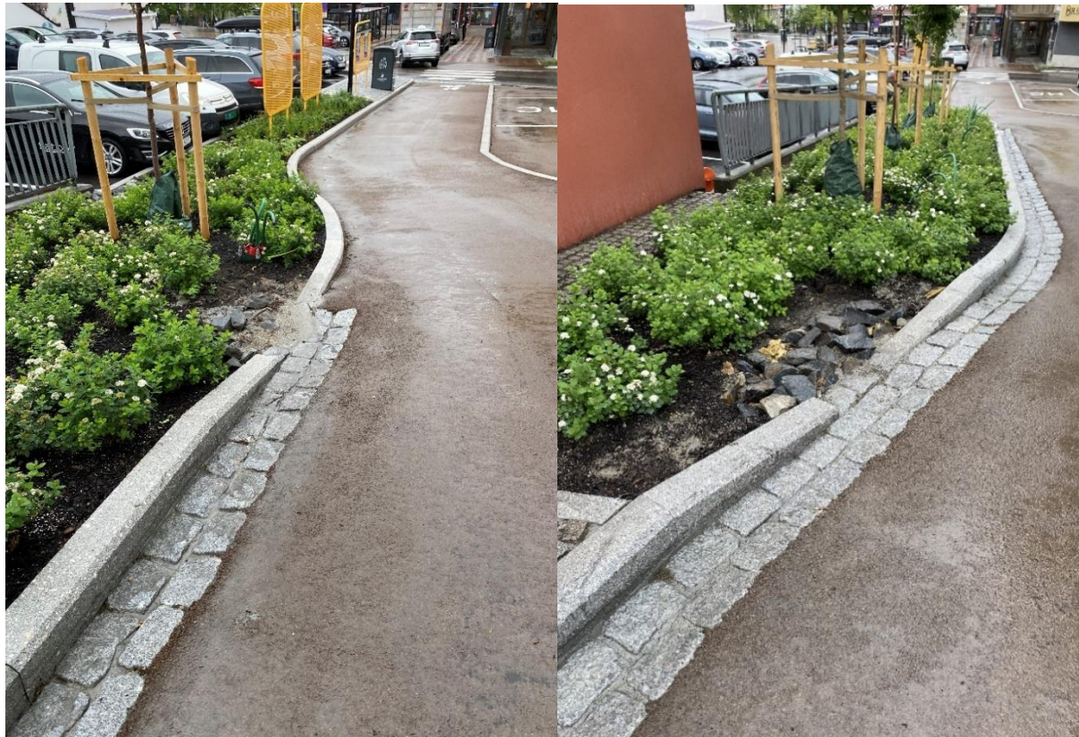
Bilde 3: Overvann ledes inn i plantefelt i Gamlevegen/Nordsetervegen
